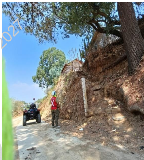
Ilustración. Zona de riesgo de un posible deslave.
